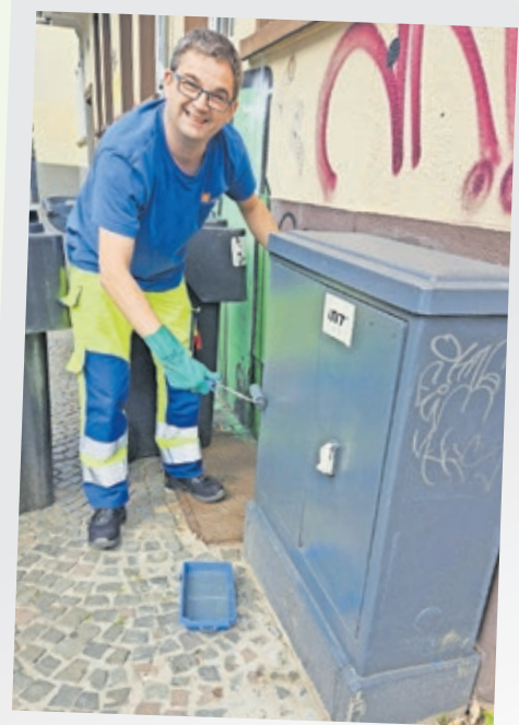
Ein Mitarbeiter der Stadtwerke Saarbrücken Netz AG reinigte einen Verteilerkasten in der Bismarckstraße.
