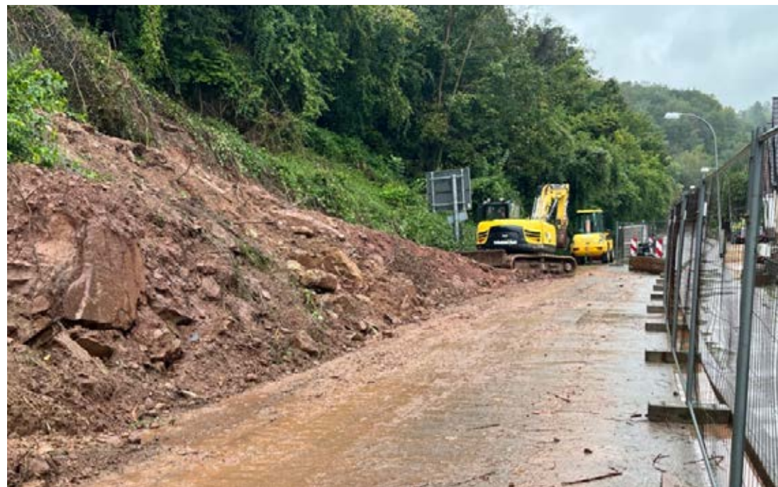
Abb.3b: Umfassende Sicherung- und Sanierungsmaßnahmen nach dem Hangrutsch an der Heringsmühle (Foto: LHS)
