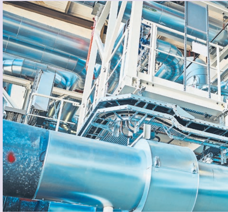
Blick ins Kraftwerk an der Römerbrücke.
